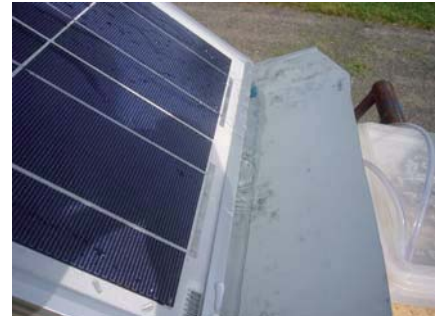
Abb. 51: mit Wasser gefüllte Auffangschale
