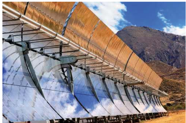
Abb. 9 Parabolrinnenkraftwerk in Andalusien
